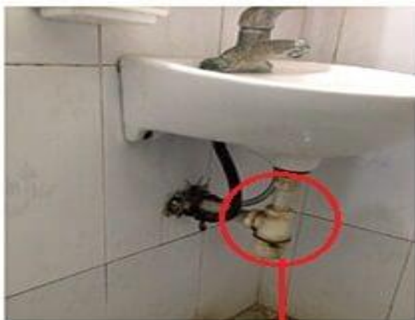
Bồn, đường ống nước, nền nhà bị ố vàng
