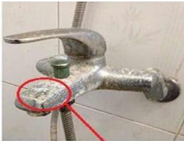
Vòi nước bị hoen rỉ, xỉn màu
